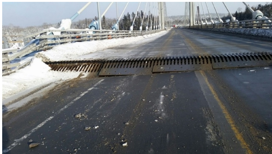
Figure 1-1 : Pont de la rivière Nipigon – soulèvement de 600 mm du bord nord du pont à la culée ouest le 10 janvier 2016
