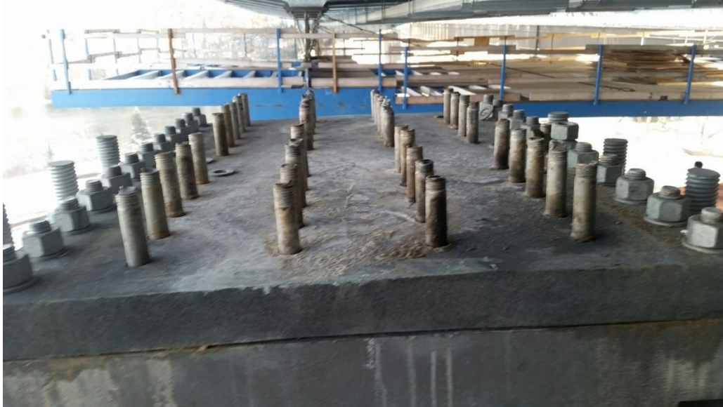
Figure 1-2 : Boulons rompus (boulons ASTM A490 reliant la plaque semelle à l'aile de la poutre maîtresse) et plaque semelle déformée à l'appareil d'appui ouest. Noter les quatre rangées de boulons de raccordement d'aile défailants.
